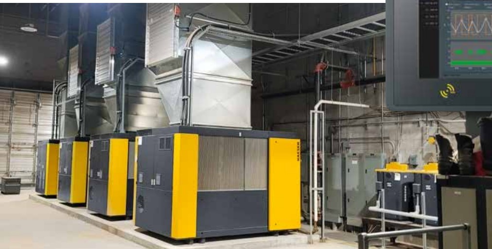
Den frekvensstyrede skruekompressor dækker spidsbelastningerne, mens de tre skruekompressorer med fast omdrejningstal dækker grundbehovet.
