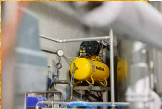
Browar Friedmann od wielu lat wykorzystuje sprężone powietrze z kompresorów tłokowych firmy KAESER KOMPRESSOREN.
