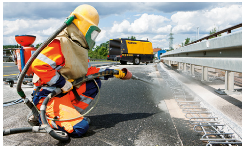
Mobile kompressorer fra KAESER sørger for en ensartet, pålidelig tryklufforsyning, der er perfekt egnet til klargøring og rengøring af overflader udendørs såvel som indendørs.
