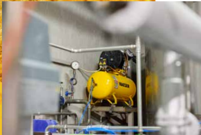
La cervecería Friedmann lleva muchos años confiando en el aire comprimido de los compresores de pistón de KAESER.
