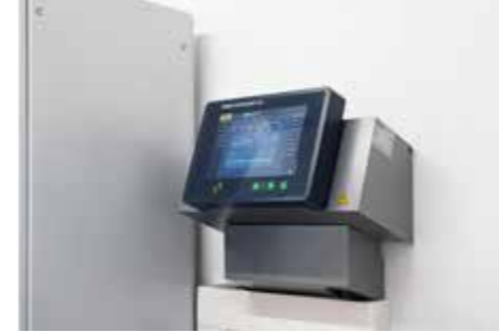
Foto superior: El SIGMA AIR MANAGER 4.0 funciona en perfecta armonía con el sistema de control de la planta.
