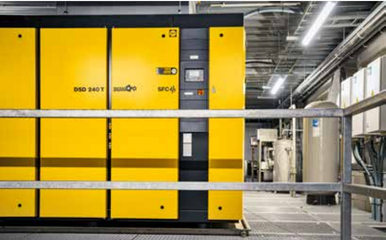
Três compressores de parafuso DSD 240 T SFC com regulação de frequência com secador integrado garantem um fiável fornecimento de ar comprimido na empresa.
