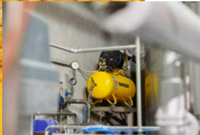
Brauerei Friedmann baut seit vielen Jahren auf Druckluft von Kolbenkompressoren aus dem Hause KAESER.
