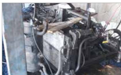
1. ábra: Elhanyagolt kompresszorállomás
