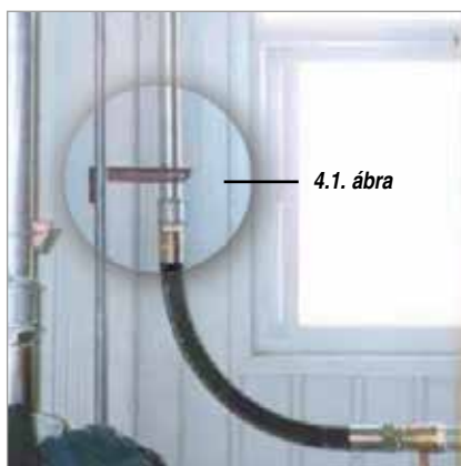
4. ábra: Vibrációt kiküszöbölő kompresszorcsatlakoztatás tömlő segítségével
