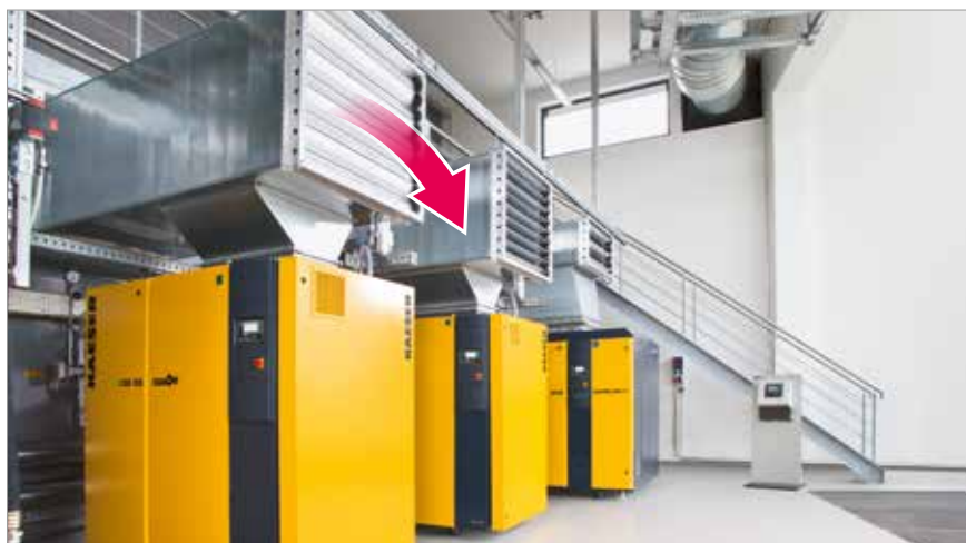
3. ábra: Kompresszorállomás termostáttal vezérelt levegőkezeléssel
