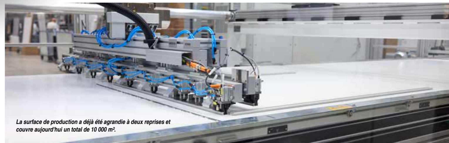
Le concept de durabilité a également joué un rôle important dans le choix des composants de la station d'air comprimé.
