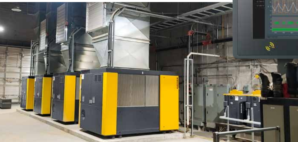
Le compresseur à vis à vitesse variable répond aux pics de demande, tandis que les trois compresseurs à vis à vitesse fixe couvrent les besoins de base.
