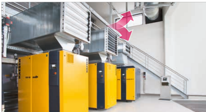
Imagen 3: Estación de aire comprimido con flujo de aire regulado por termostato.
