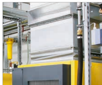
Imagen 2: Conexión de ventilación del compresor con empalme de lona.
