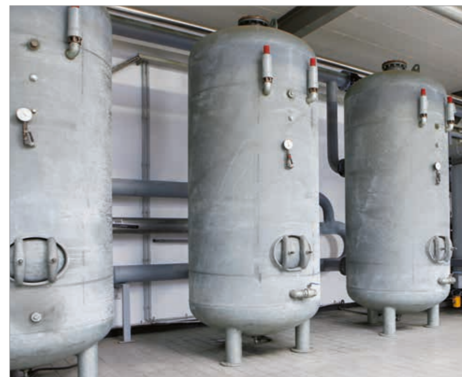
Imagen 4: Depósito de aire comprimido de reserva.
