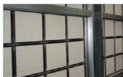
Imagen 2b: Sistema de filtros del aire de enfriamiento
