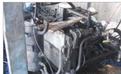
Imagen 1: Estación de aire comprimido descuidada.
