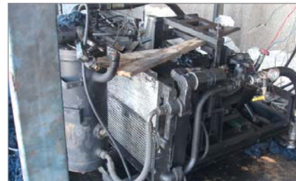
Figura 1: Estación de aire comprimido descuidada
