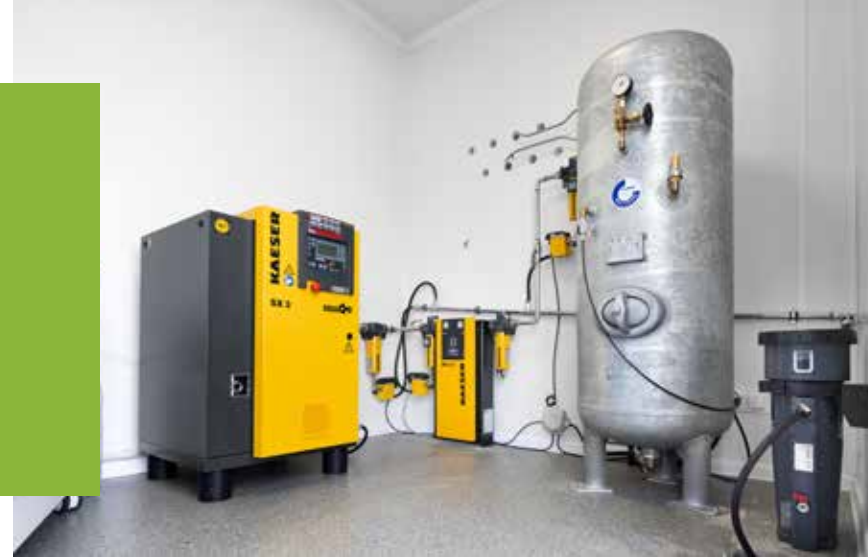
SX 3 -ruuvikompressorissa on kehittynyt paineilman jälkikäsittely ja 250 litran paineilmasäiliö.
