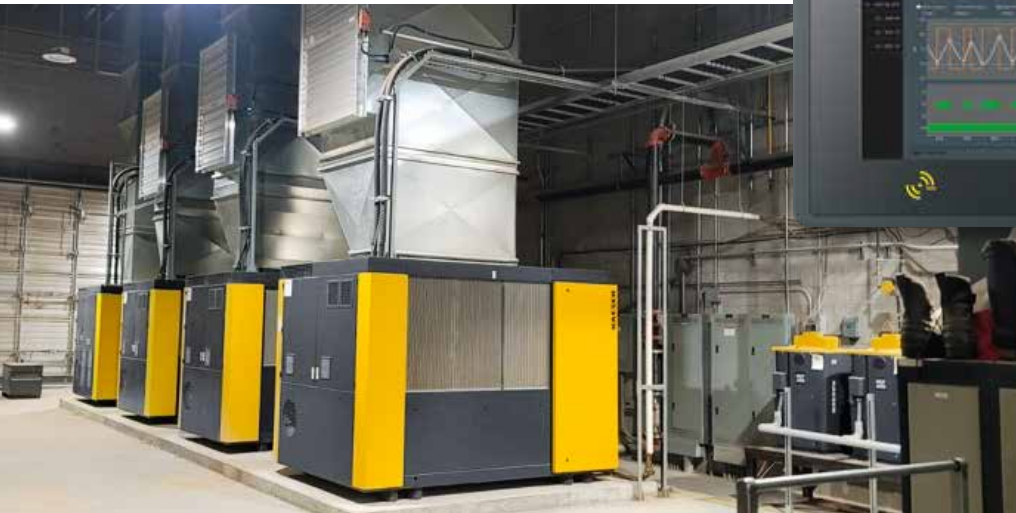
Taajuussäädetty ruuvikompressori kattaa tarvehuiput samalla, kun kolme kiinteällä kierrosluvulla varustettua ruuvikompressoria kattavat perustarpeen.
